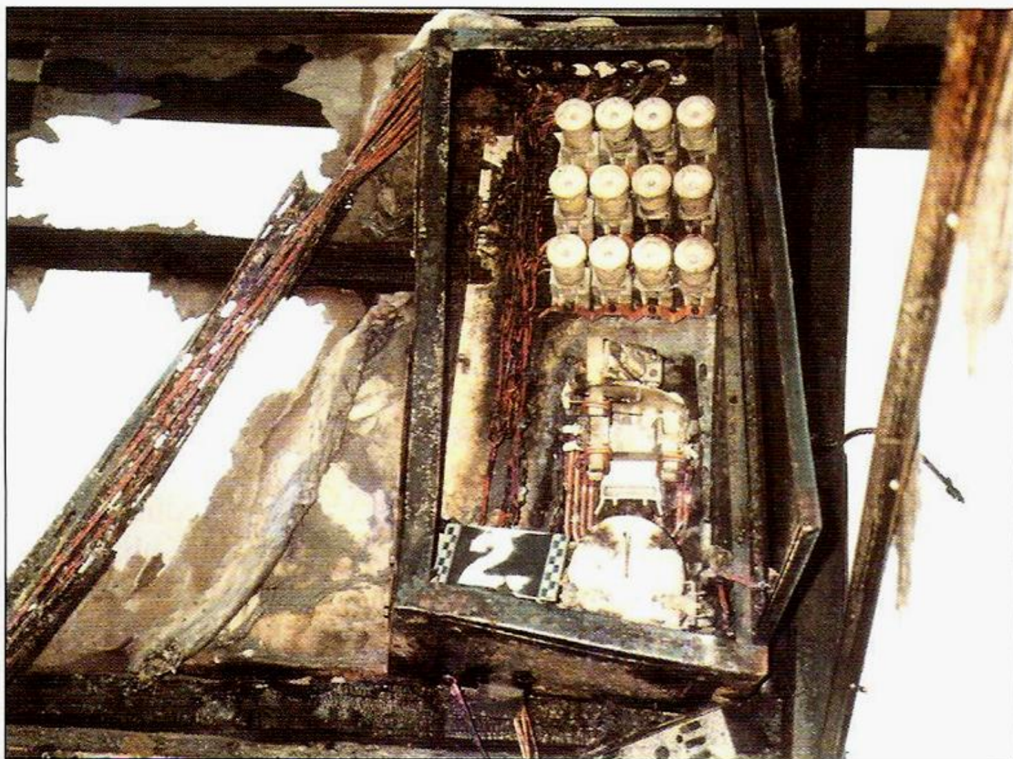
Slika 53. Ormar koji je ostao nakon požara. Tijela osigurača kao i patrone nisu oštećeni i može se obaviti pregled svake patrone zasebno.
