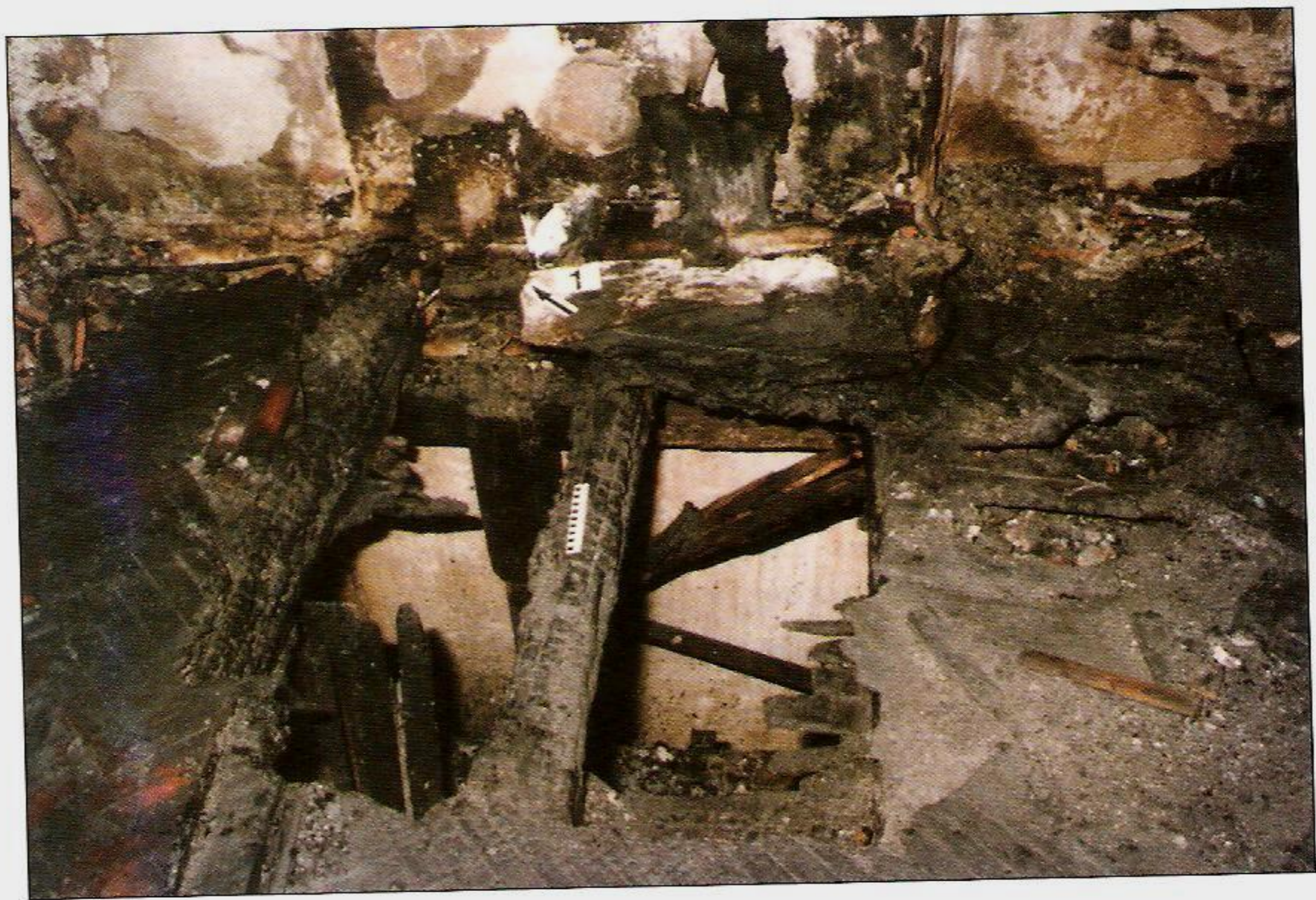
Slika 33. Izgled mjesta na kojem je najdulje trajao požar, pa s obzirom da se radi o drvenom podu, došlo je do lokalnog progorjevanja poda.
