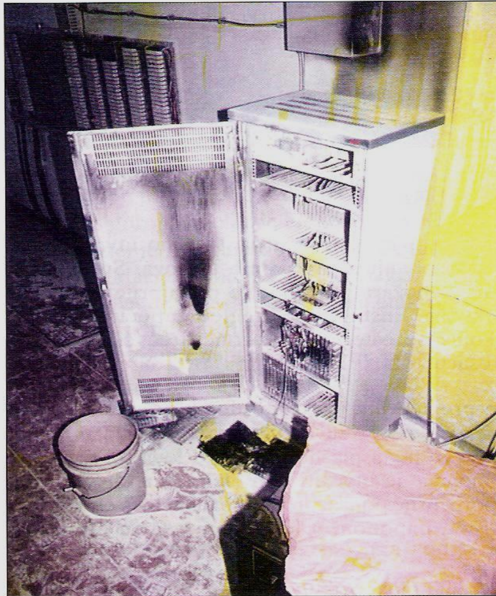
Slika 50. Podnožje traga zacrnjenja u obliku slova V (upućuje na mjesto gdje je tinjajući požar započeo)
