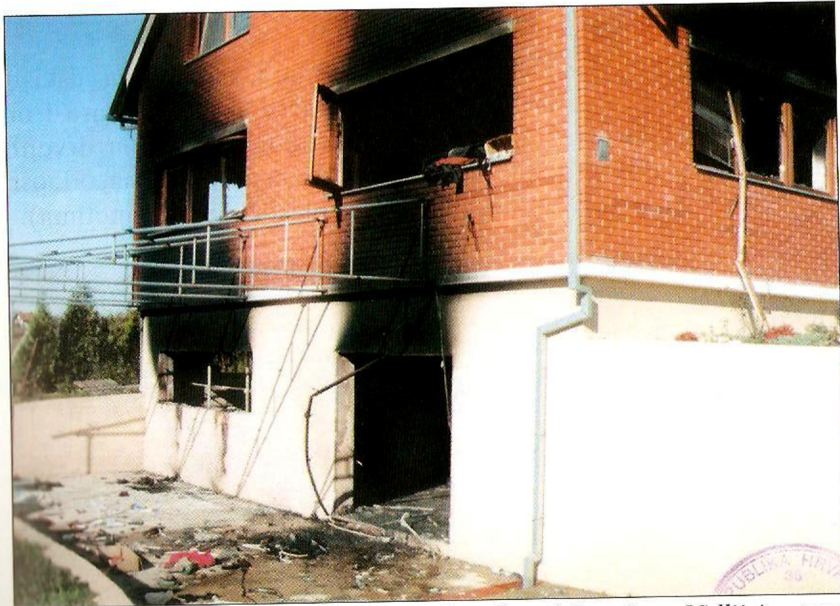
Slika 31. Izgled vanjske strane objekta nakon događaja požara. Vidljivi su tragovi zacrnjenja nastali kao posljedica kondenzacije plinovitih produkata izgaranja.
