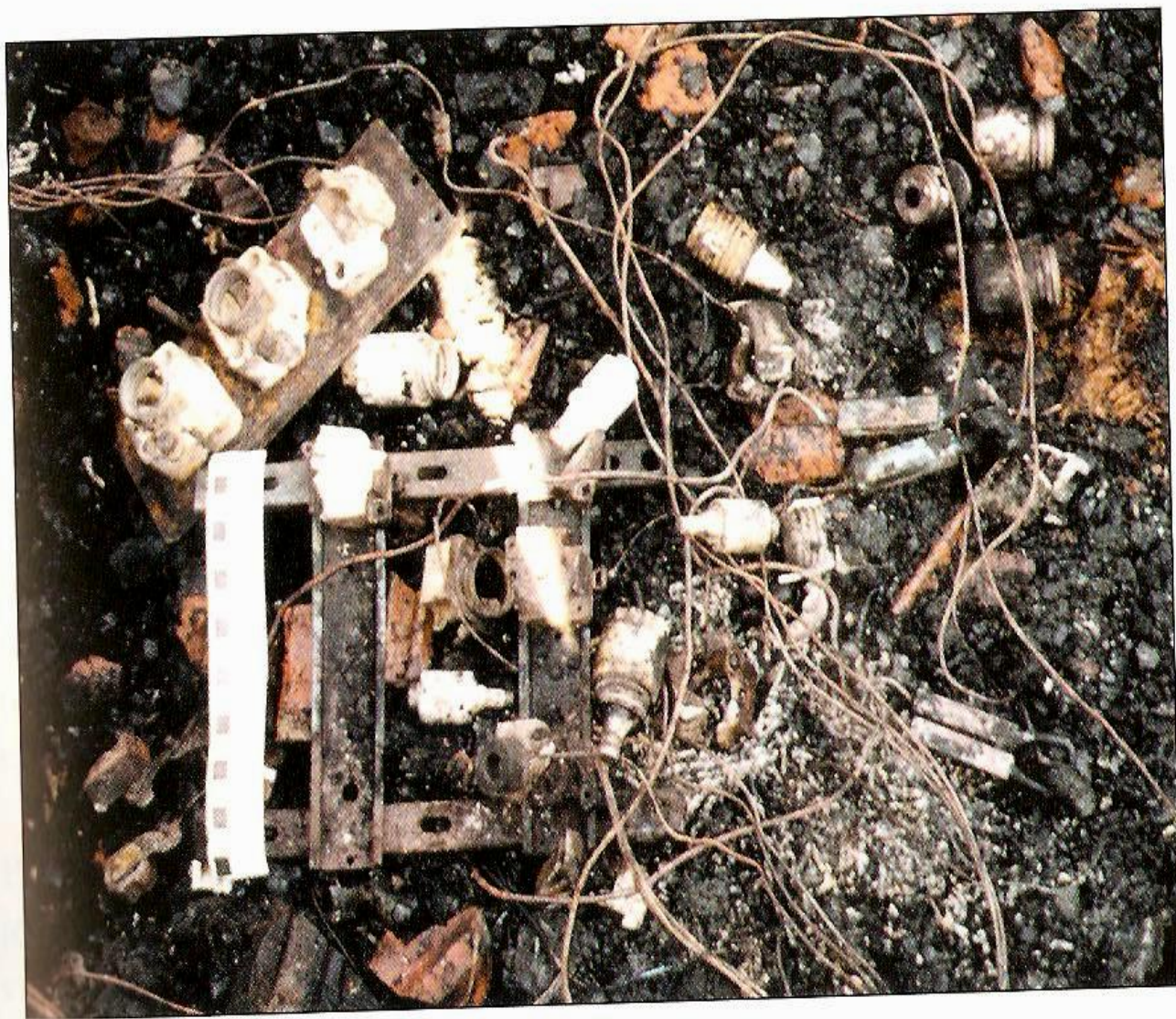
Slika 49. Stanje električne instalacije kakvo se često zatječe na mjestu događaja požara objekta
