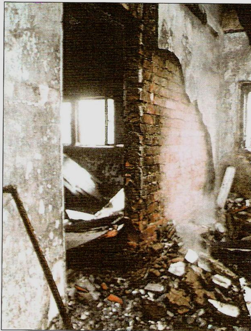
Slika 48. Prikaz otpale žbuke na mjestu intenzivnog djelovanja požara
