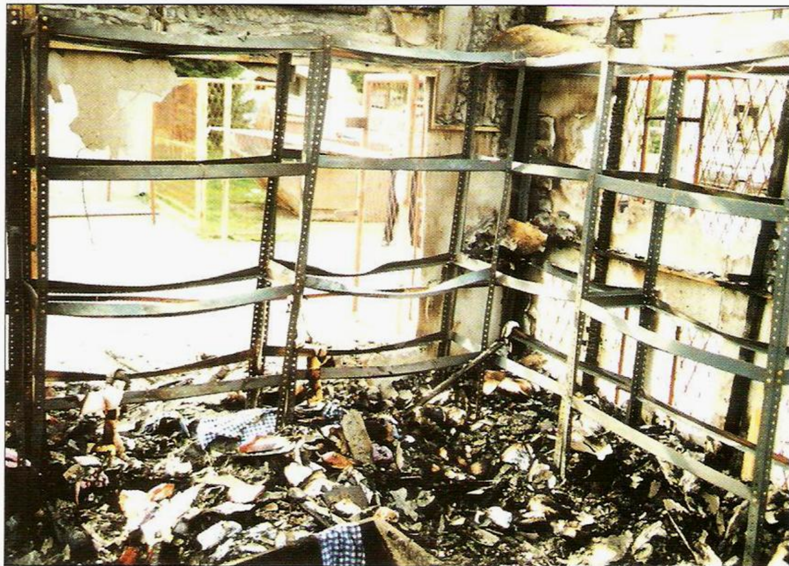
Slika 45. Prikaz posljedice djelovanja požara na metalne konstrukcije. Vidljivo je da dolazi do plastičnih deformacija u vidu savijanja i izvijanja.
