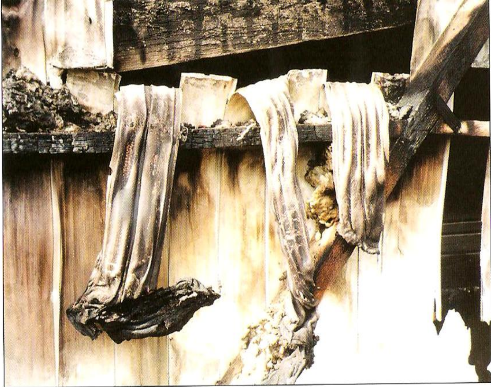
Slika 44. Prikaz oštećenja plastike u vidu taljenja, a kao posljedica izloženosti požaru
